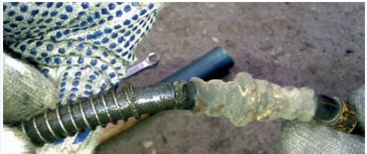
Неправильный монтаж, выражающийся в перенручивании трубки, приводит к быстрому ее выходу из строя
