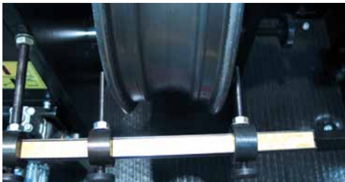
Ширину ремонтируемой части в процессе ремонта необходимо тщательно контролировать при помощи точной линейки.
