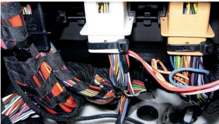
Некачественная прокладка проводки для подключения дополнительного оборудования, например комплекса для подогрева сидений, часто приводит к повреждению изоляции проводов
