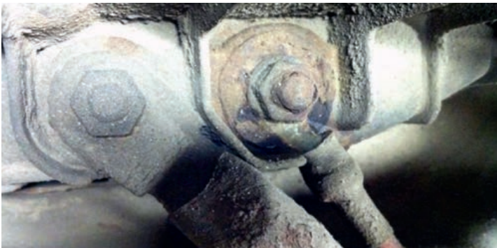
Обнаружив подгоревшие провода, необходимо произвести их ремонт или замену
